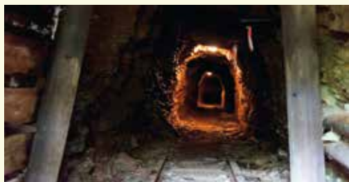
Der Heinrichstollen wurde erst im Jahr 1914 bei der Suche nach Eisen- und Manganerzen angelegt.
